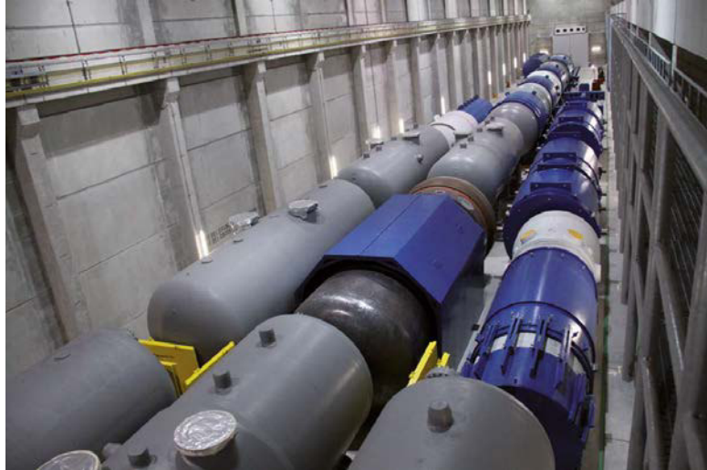
Abbildung D-9: Abklinglagerung von Großkomponenten (Dampferzeuger, Reaktordruckbehälter) im Zwischenlager Nord (Bildrechte: EWN)
