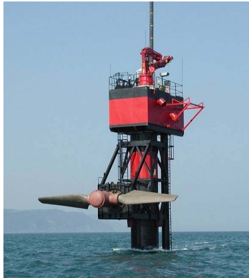
Abbildung 5: Foto der Strömungsturbine „Seaflow“ während einer Wartungsphase. Die Turbine mit einer Nennleistung von 300 kW ist seit 2003 bei Lynmouth, Devon (GB), 3 km vor der Küste in der Nordsee installiert. [Quelle: Marine Current Turbines Ltd. ]
