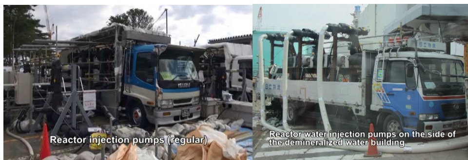
Abb. 2: Reaktoreinspeisepumpen und Ersatzaggregate
