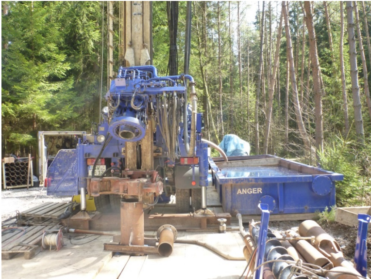
Abb. 10-1 Bohrerät für die Aufschlussbohrung im quartären Maar bei Neu-albenreuth (Foto F. Nützel, Piewak & Partner GmbH).
