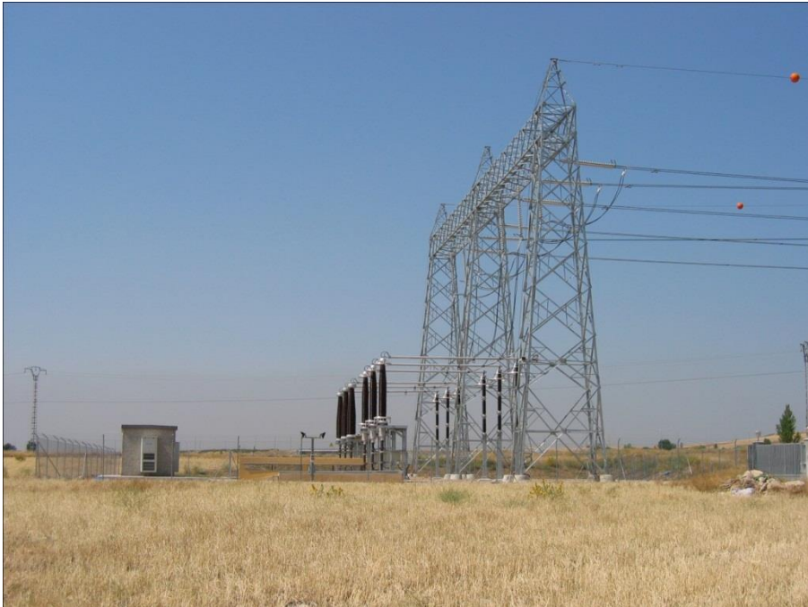
Bild 7 Übergangsanlage Kabel–Freileitung: Gesamtansicht (von rechts nach links) mit Abspannportal, Überspannungsableitern, Kabelendverschlüssen, Gebäude und umzäuntes Grundstück
