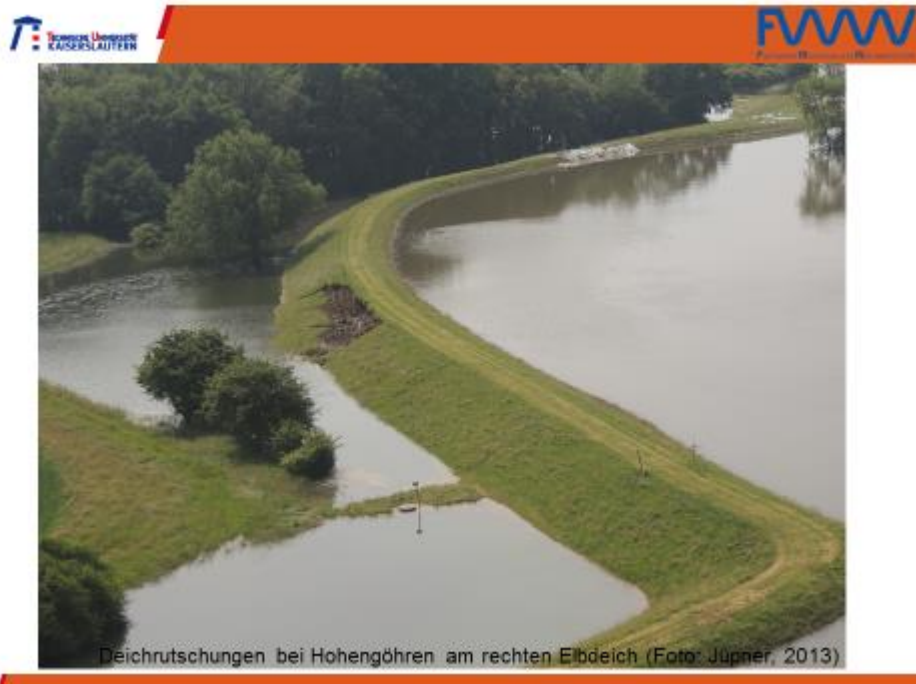
Folie 4: Deichrutschung bei Hohengöhren an der Elbe nahe Fischbeck im Juni 2013
